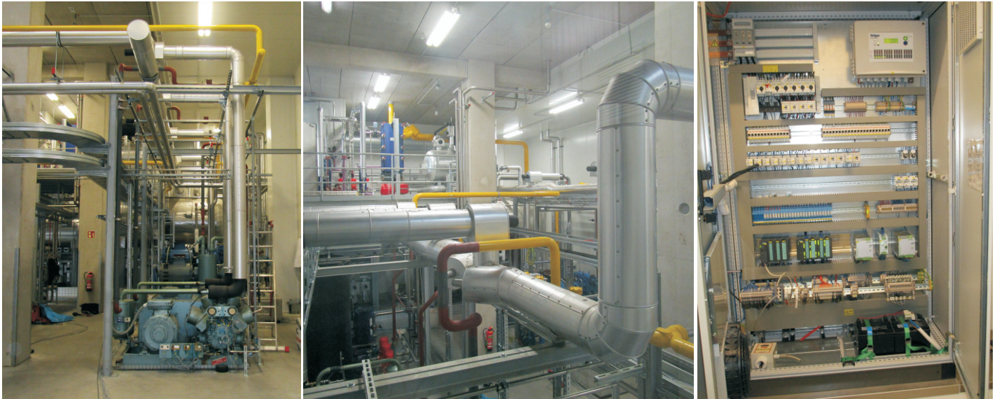
Links: NH 3 - Kältemaschinenraum, im Vordergrund der HD-Kolbenverdichter V5. Mitte: Der Kältemaschinenraum aus anderer Perspektive, im Hintergrund oben die WRG-Übergabestation (Wärmerückgewinnung). Rechts: Schaltschrank mit der NH 3 -Gaswarnanlage und der Siemens S7-Anschaltung.
